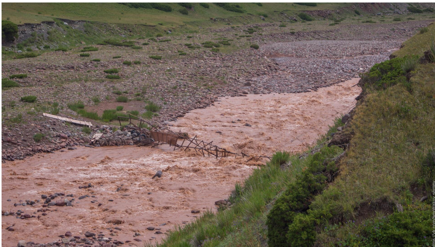
Фото 1.2. Разрушенный мост через реку Нура
