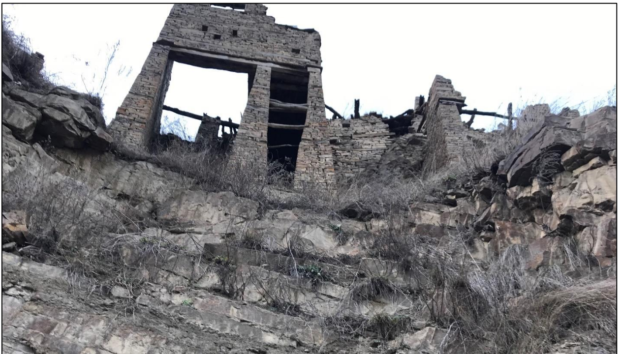
Рисунок 41 – Разрушающие постройки в селе Тама в Кайтагском районе Дагестана
