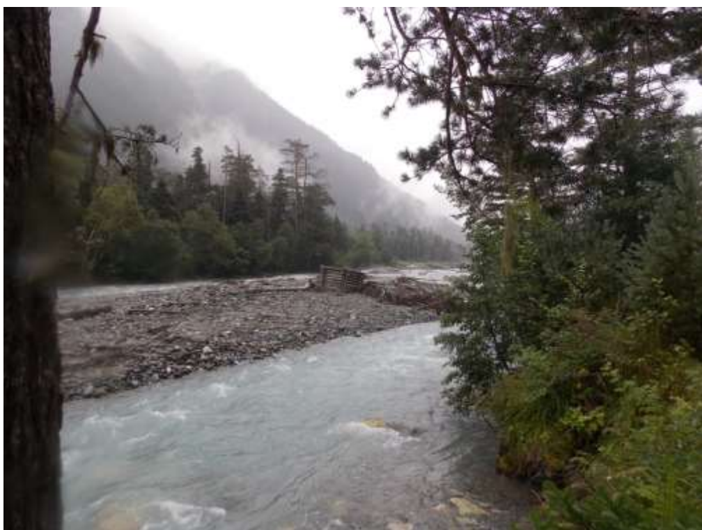
Рисунок 80. Разрушенный мост через р. Псыш
